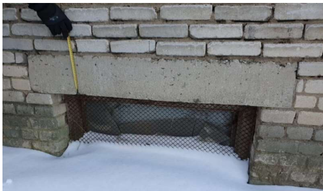
Foto 20. Näidisfoto Keskpuiestee 43 raudbetoonist ülemisest aknasillusest
