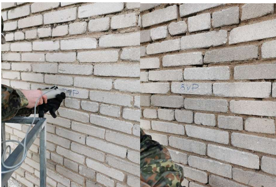
Foto 25. Mittepurustav põrkevasara katse vastu Keskpuiestee 43 silikaatkivimüüritise väliskoorikut (vasakul); uuritav silikaatkivi pind peale põrkevasara katset (paremal)
